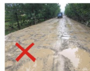
坑洼、颠簸路面
